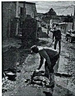
ATENCION A FALLAS DE SUMINISTRO DE AGUA Y TAPONAMIENTOS
